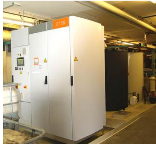
Bild Nr. 05-02 MK_B-ET50-totale.jpg. Verdampferanlage von MKR Metzger. Im Hintergrund die Behälter für verbrauchtes (schwarz) und wiederaufbereitetes Prozesswasser (weiß).
